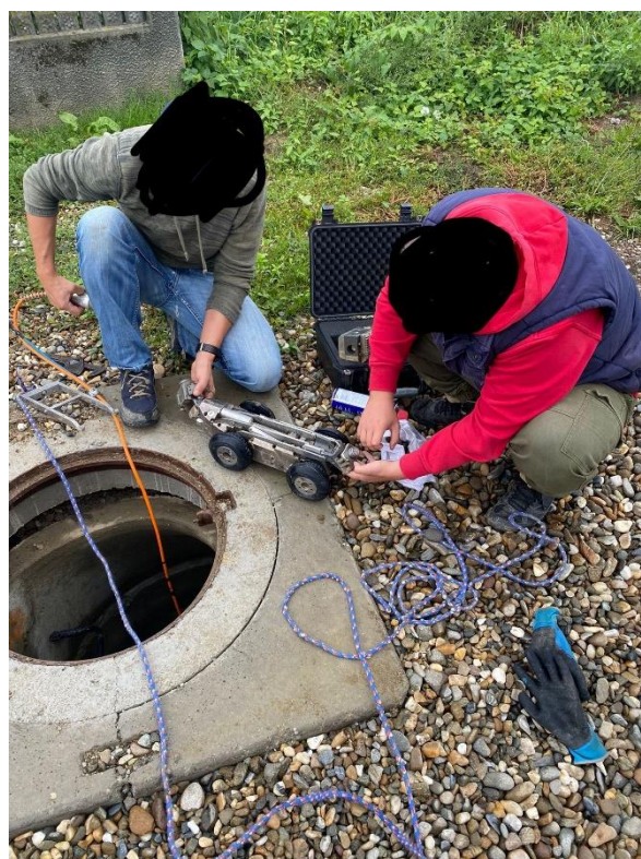
Reteag, com. Petru Rareș Inspecție video la căminul de canalizare Septembrie 2022
