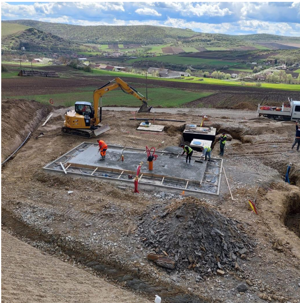
Gospodăria de apă ARCHIUD – 03.04.2024
