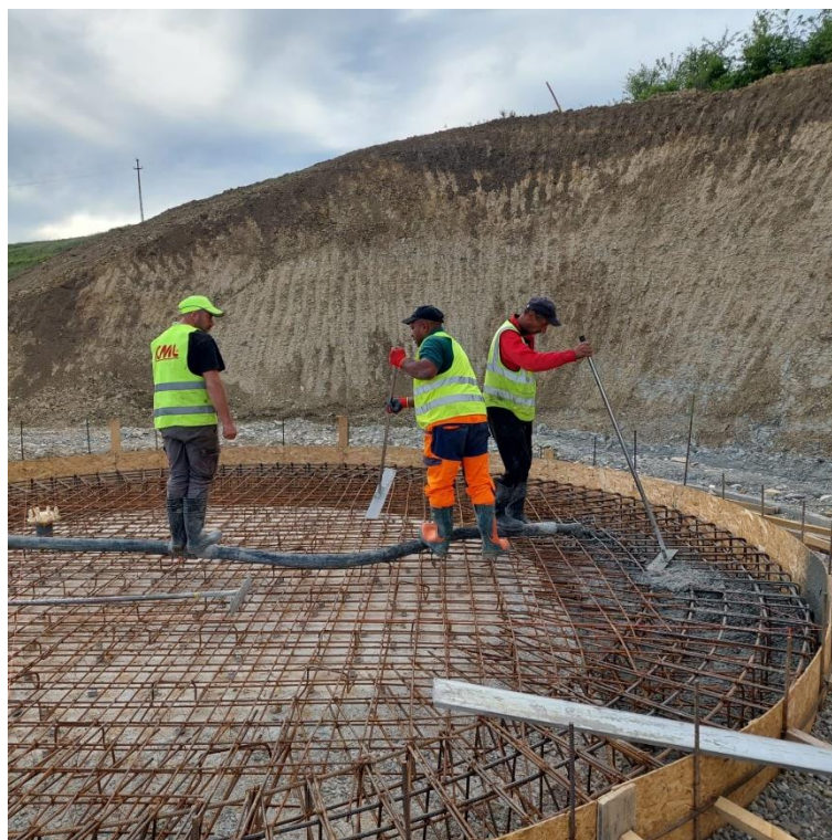
Gospodăria de apă ARCHIUD – 02.05.2024
