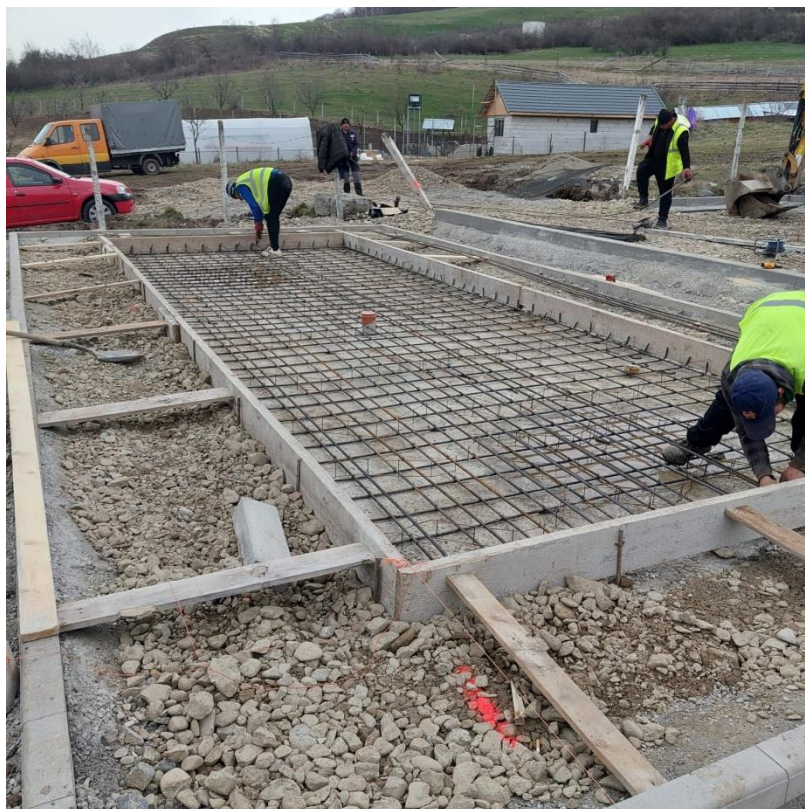
Stația de pompare apă potabilă SĂRĂȚEL – 13.03.2024
